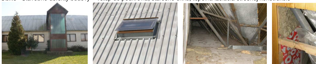
Obr.8 Stavebné defekty budovy – vstup do podkrovia, strešné okná, tepelná izolácia strešnej konštrukcie
