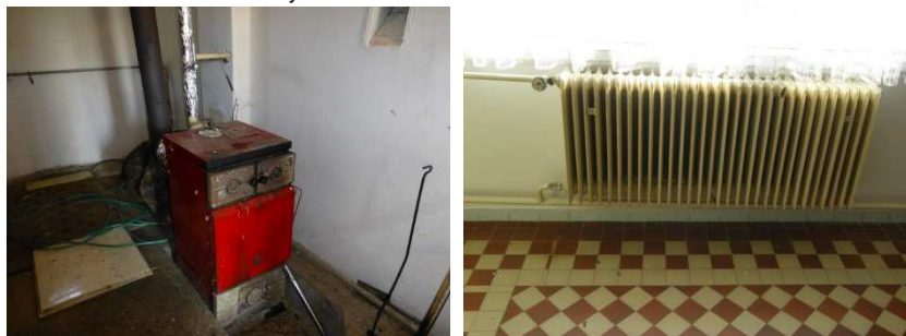
Obr.14 Pohľad na kotol a vykurovaciu sústavu
