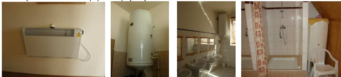
Obr.9 Vykurovacia sústava a príprava teplej vody
