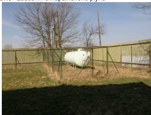
Obr.6 Zásobník skvapalneného plynu
