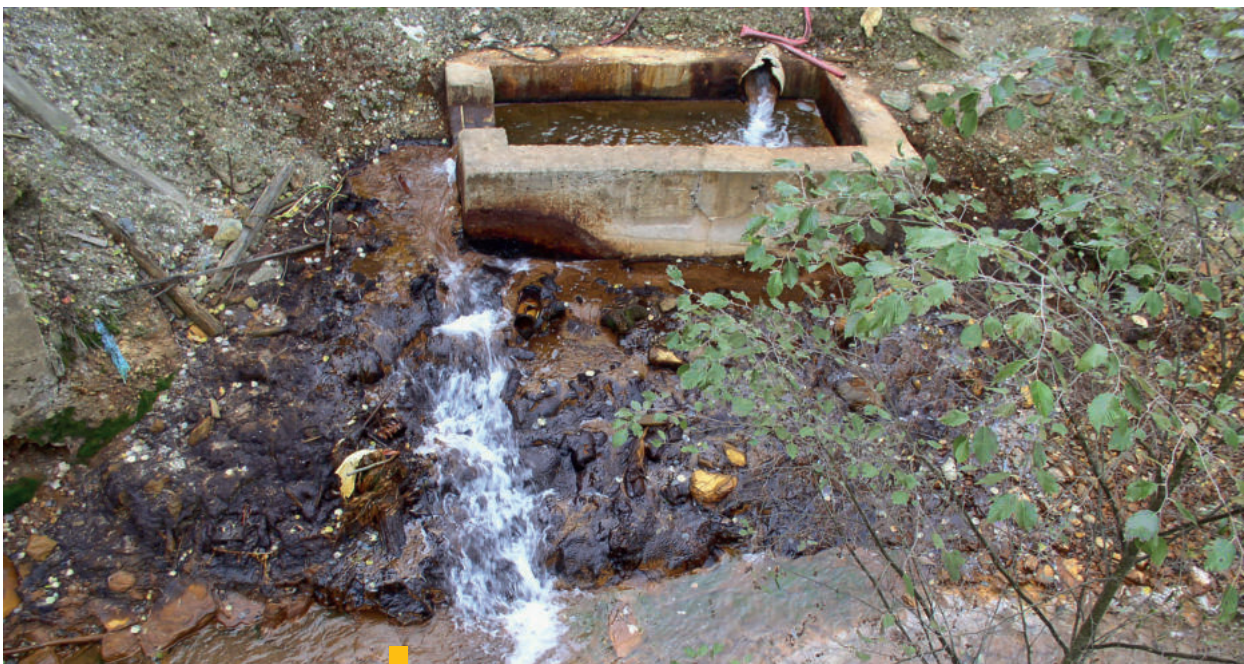
3 Drenáž šachty Péch privádzajúca banské vody do potoka Smolník. Drenážny kanál odvádzajúci vody z telesa odkaliska v Smolnickej Hute foto: Archív PRIF UK Bratislava
