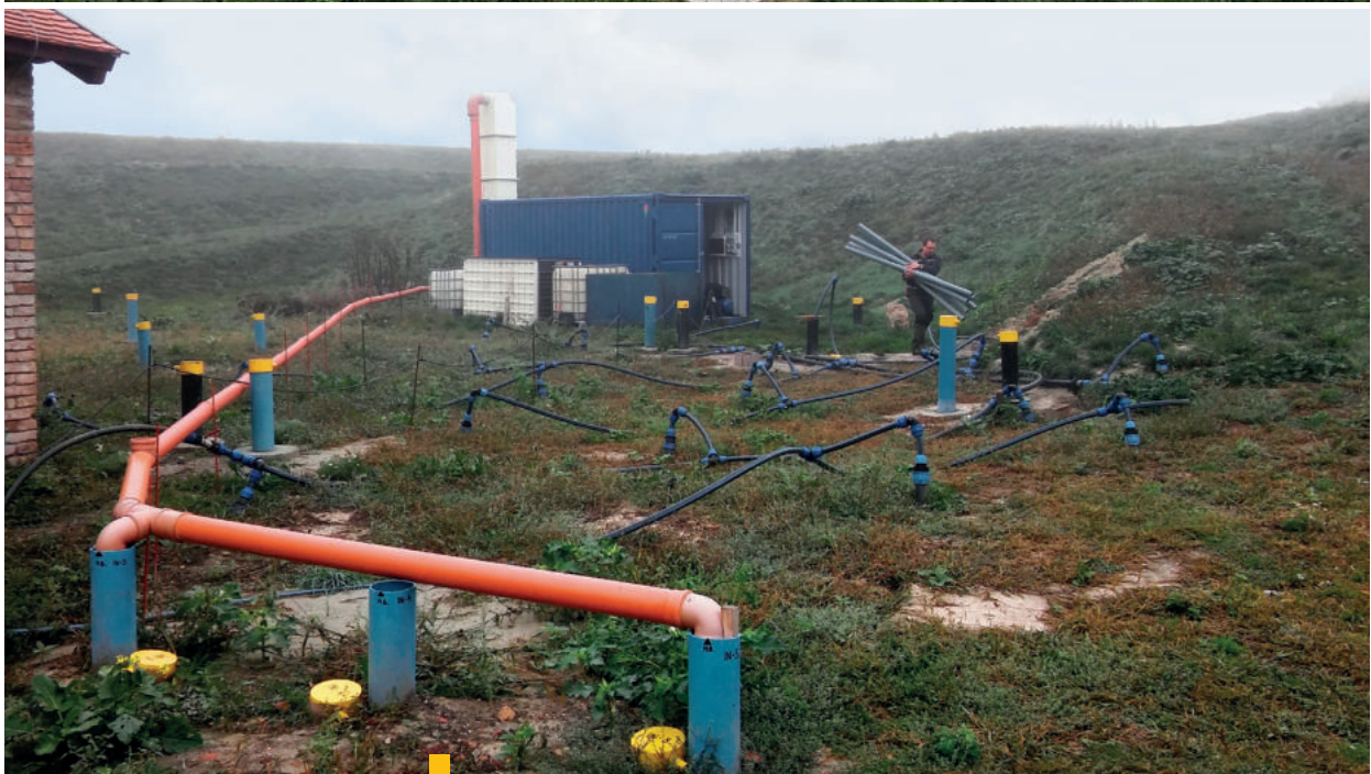
18 | 19 Obr. č. 16, 17, 18 a 19 – sanácia zemin pásma nasýtenia a podzemnej vody metódami in situ
