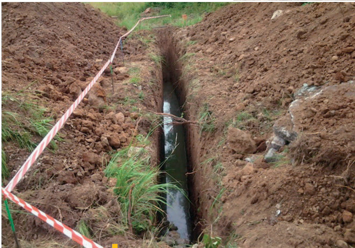
16 | 17 Sanačné drény na čerpanie podzemnej vody a voľnej fázy ropných látok v lokalitách Ihrisko a Pekáreň
