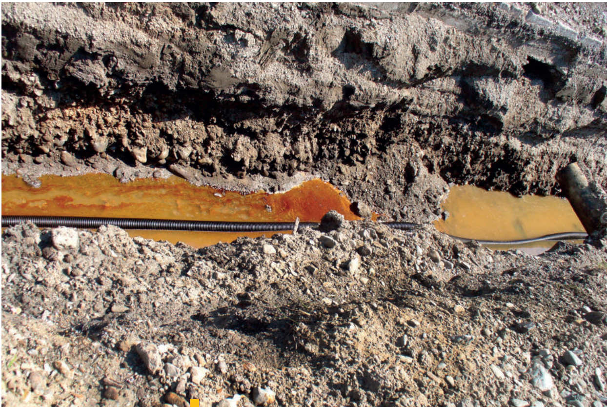
11 Sanačný drén na čerpanie podzemnej vody s voľnou fázou ropných látok
