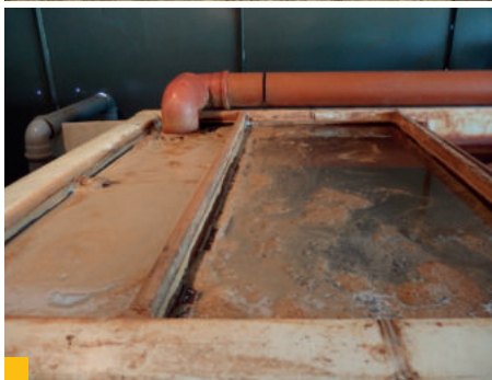
7 | 8 | 9 Technologické zariadenie na čistenie čerpanej podzemnej vody | zdroj: MŽP SR
