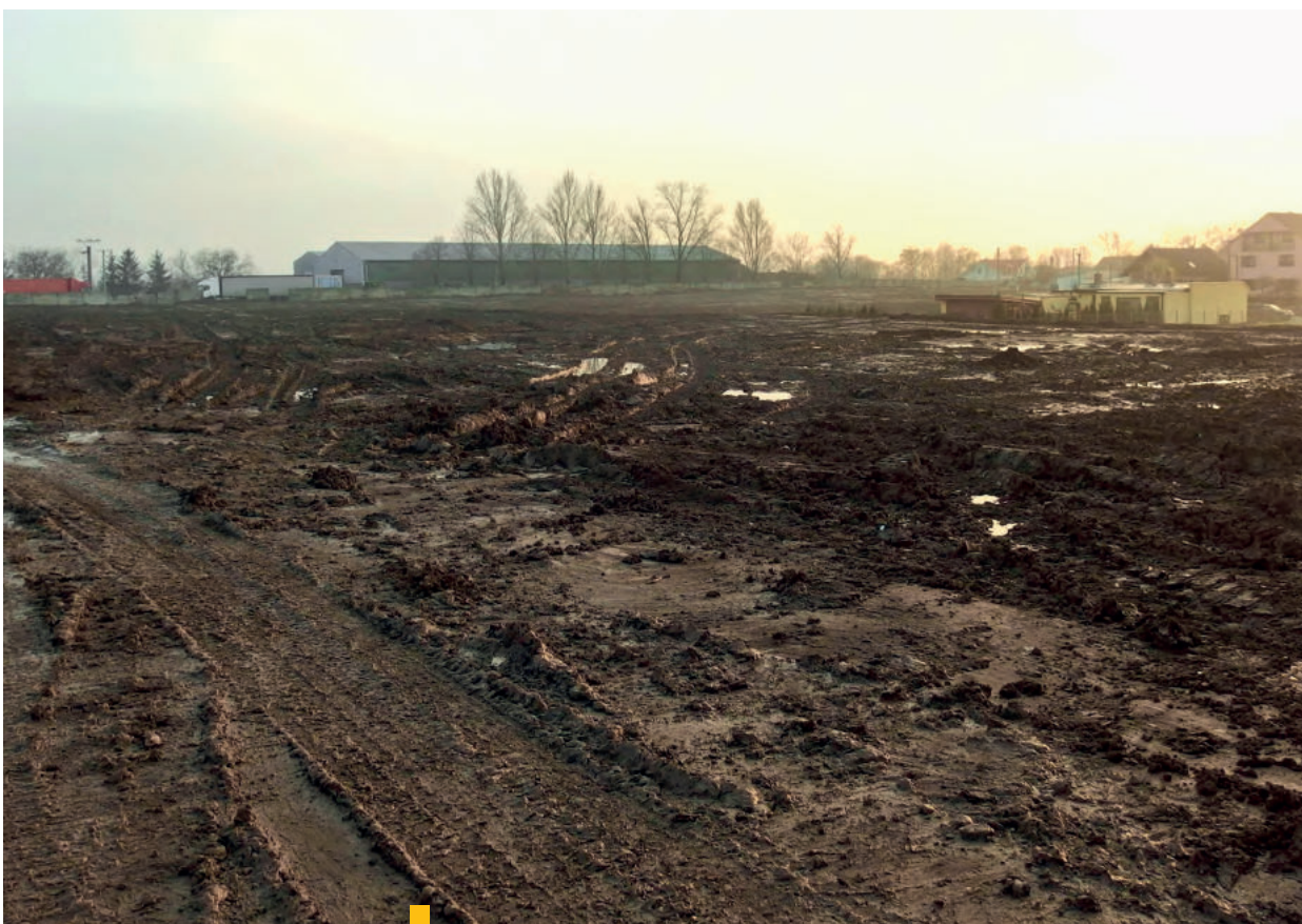
13 Obr. č. 8, 9, 10, 11, 12 a 13 – snímky dokumentujú priebeh sanačných prác, ktoré boli zhotovené počas kontrolných dní v priebehu projektu sanácie, zdroj: MŽP SR
