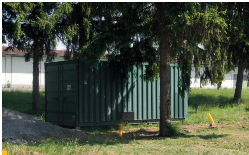
31 Objekt sanačnej technológie v lokalite Lešť – Garážové dvory
