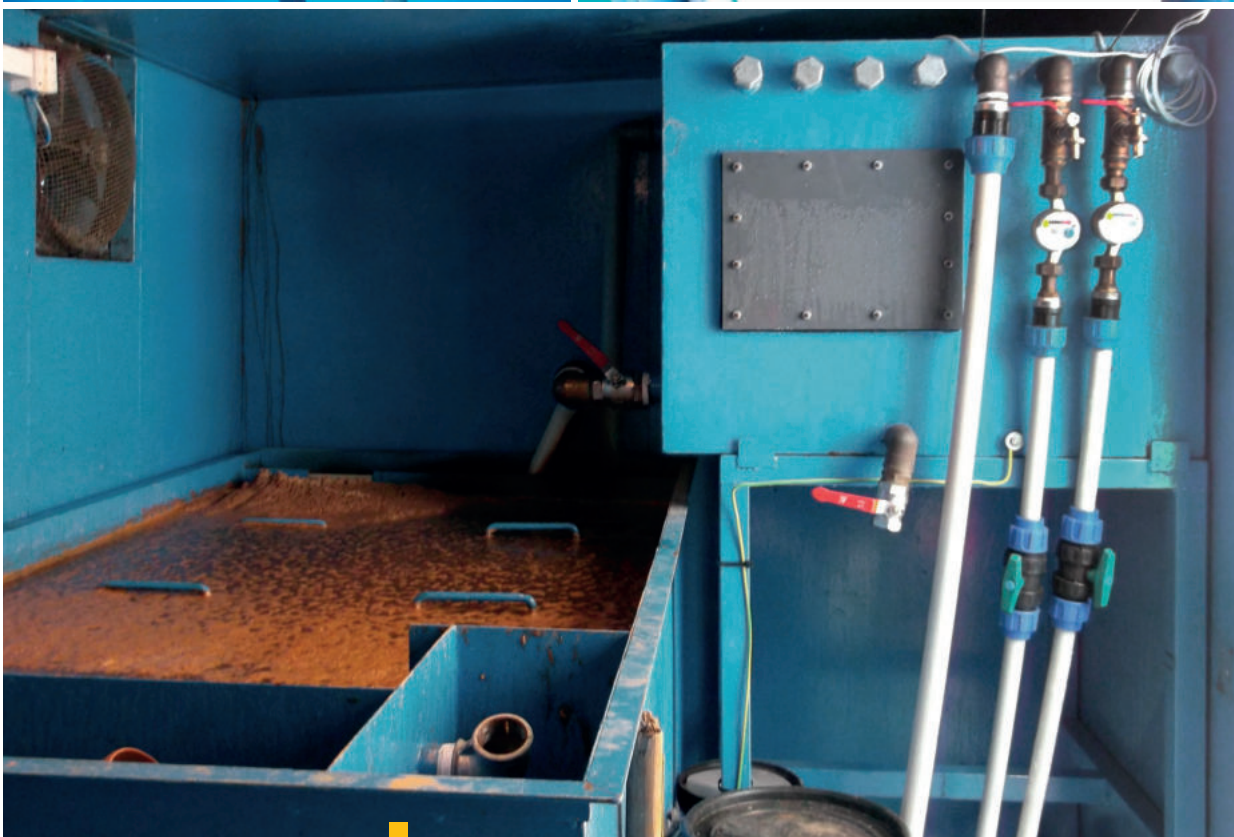
9 | 10 | 11 Interiér sanačnej stanice | zdroj: MŽP SR
