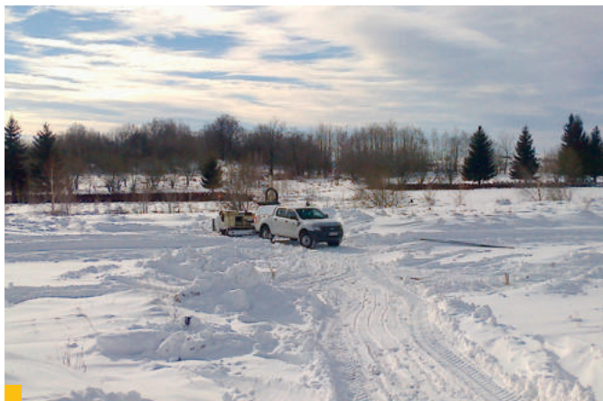
19 Realizácia prieskumných sond vzorkovacou súpravou ® Geoprobe v predsanačnej etape foto: J. Schwarz, január 2015
