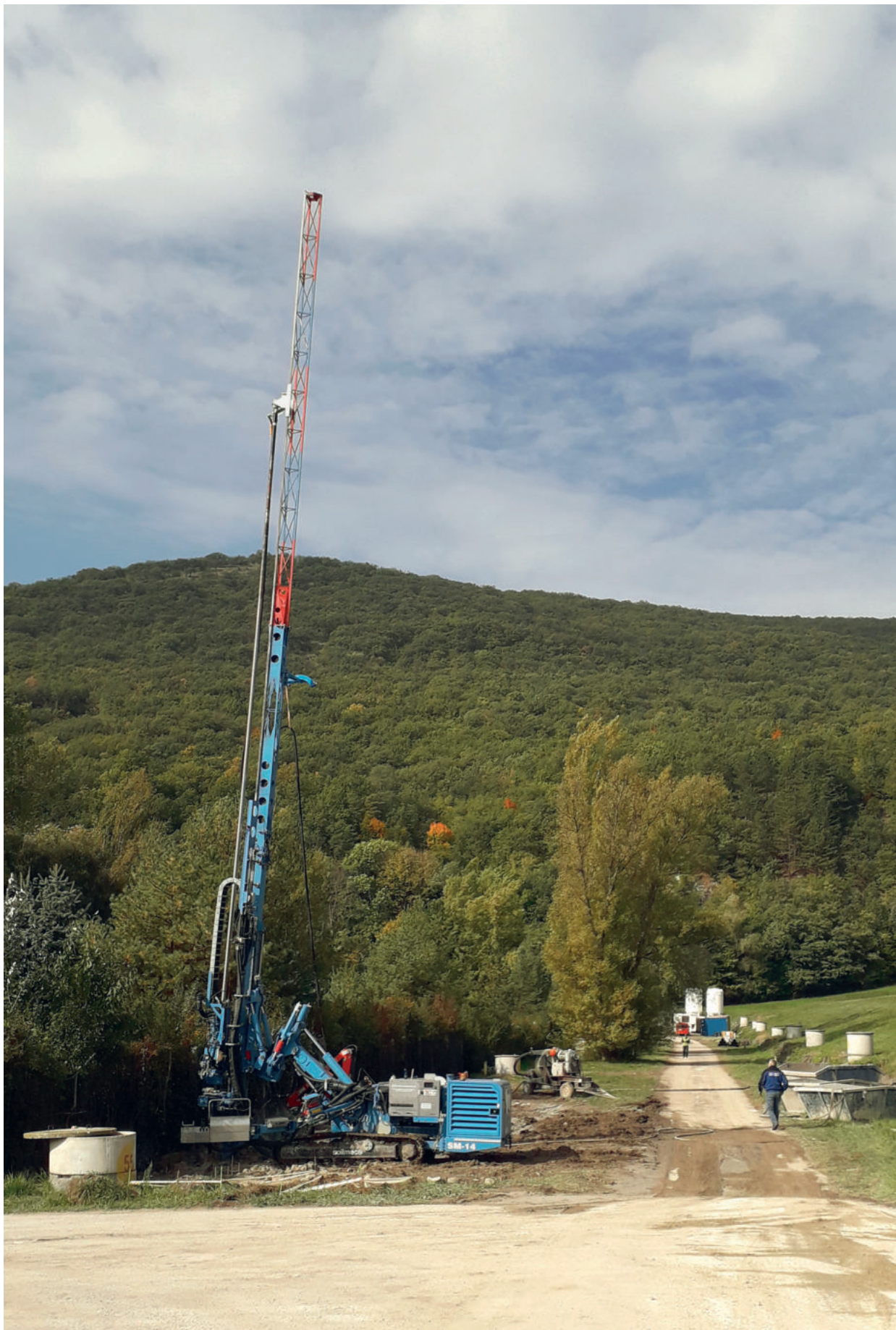
Budovanie podzemnej tesniacej steny pri dočasnom odkalisku ENO. V roku 2019 bola medzi kúpeľmi Chalmová a odkaliskom vybudovaná reakčná bariéra v celkovej dĺžke 210 metrov.
