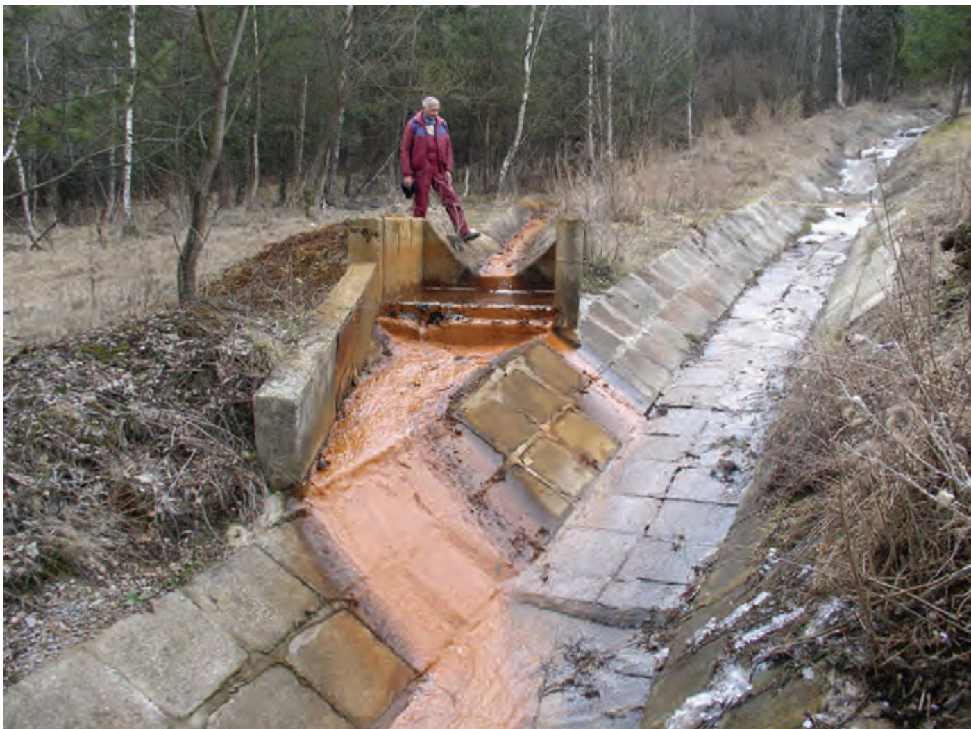
Obr. 6 Nová drenáž šachty Péch privádzajúca banské vody do potoka Smolník. Biele sekundárne minerálne fázy predstavujú oxyhydroxidy Al, hnodočervené oxyhydroxidy Fe. Drenážny kanál odvádza vodu z telesa odkaliska v Smolníckej Hute
