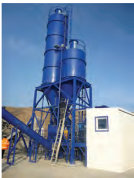
Časť technologickeho zariadenia
