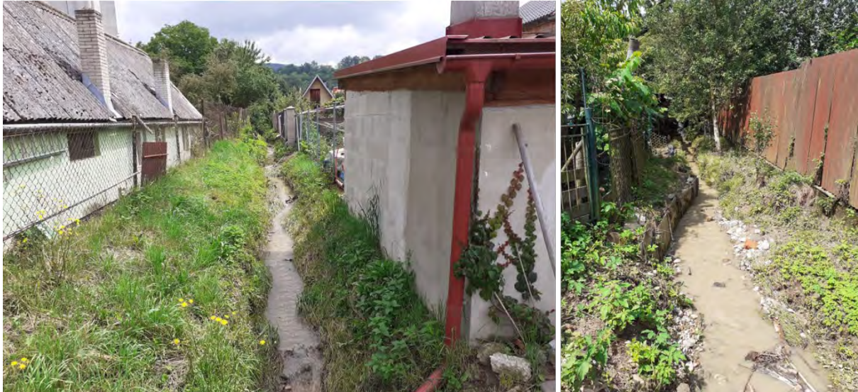
Obrázok č. 24: Zúžený profil koryta toku Moškovec stavbami (Šiman, M., 2024)
